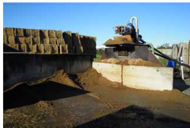
Figur 2.12. Det er planen, at der skal monteres tag over separatoren, som er placeret udendørs.
